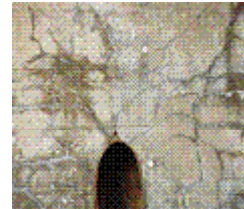
アルカリ骨材反応でひび割れが生じた橋台
